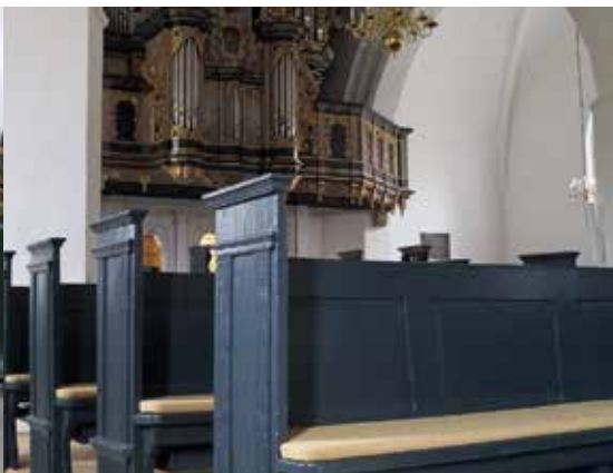
Kerteminde Kirke var en restaurationsopgave, hvor konvektorer blev monteret under kirkebænkene, og farven præcis svarer til kirkebænkens farve.
