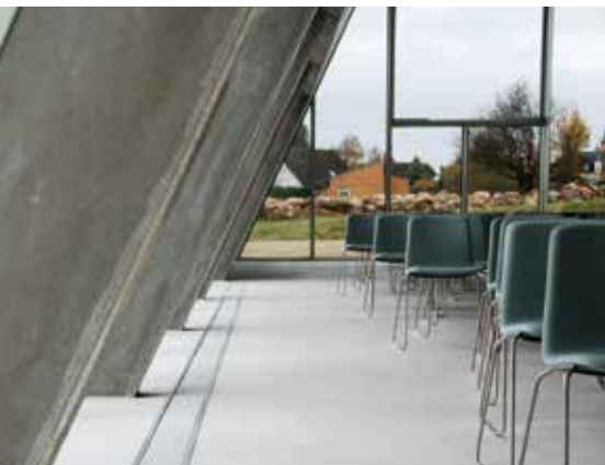
Jyllinge Kirke er en moderne kirke, hvor Meinertz leverede en diskret og stilfuld Convec FloorLine-løsning til montering i gulvet rundt om kirkerummet.
