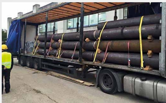
Færdige rør på fix-mål leveret skærpede til Herlev Hospital. Klar til indsvejsning.
