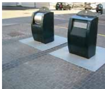
Etablering af 200 stk nedgravede affaldscontainere med chausséstensbelægning og epoxyfuger i Århus midtby
